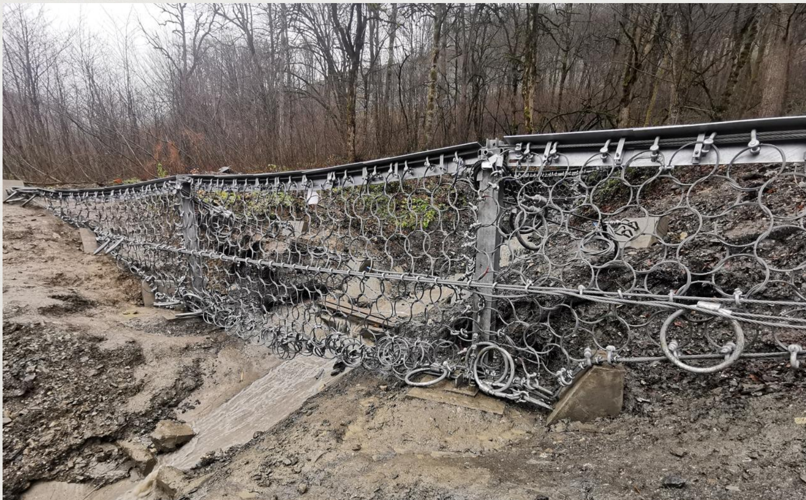
Селеудерживающий барьер. Горно-туристический центр ОАО «Газпром»
