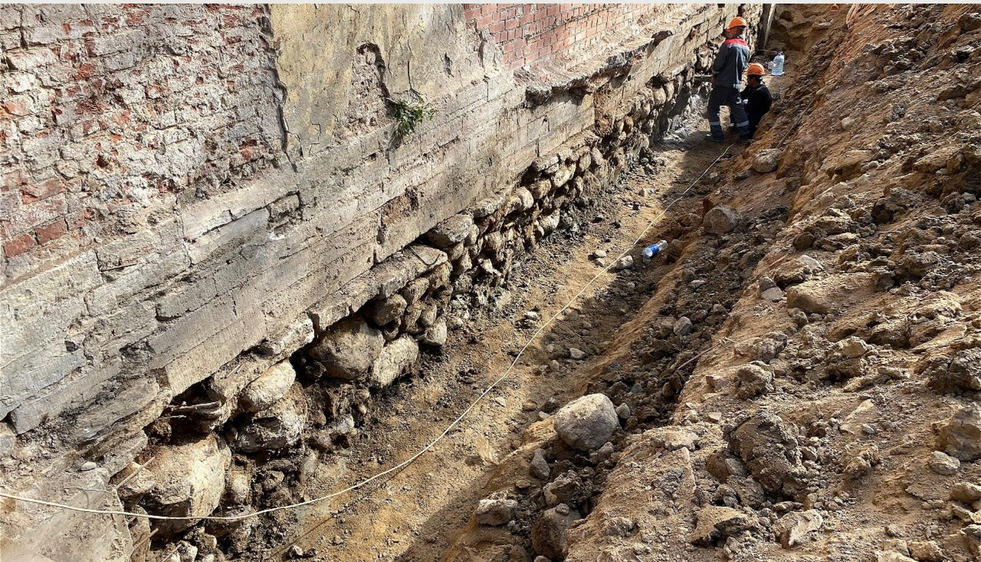
Размытые швыкладки фундамента.
