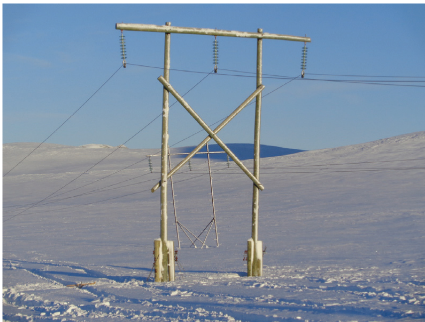
Рис. 4. Провод АААС-Z на деревянных опорах ВЛ 110 кВ, Чукотка, 2018 г.
