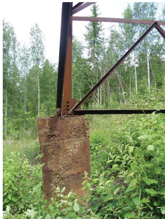
Рис. 4. Столбчатый фундамент до усиления
