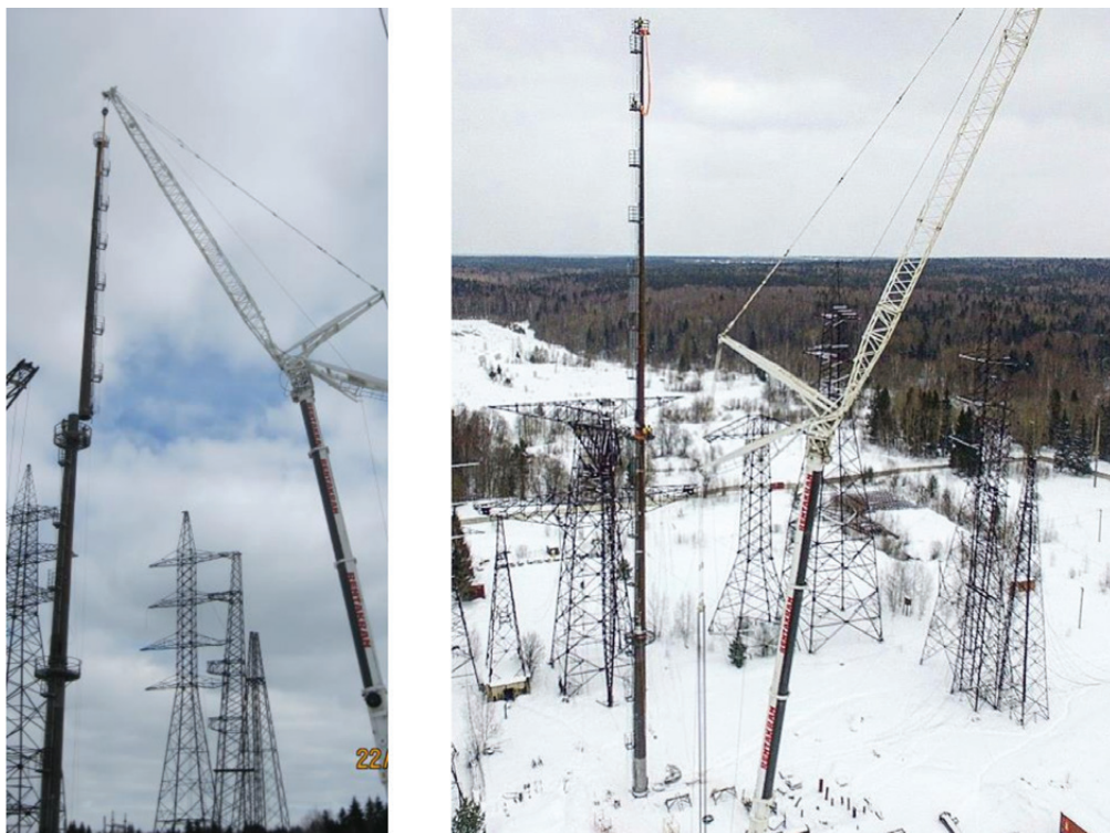
Рис. 12. Испытание молниеотводов на базе высокомачтовой опоры со стационарной короной типов ВГН-50/2-МЗ-001, ВГН-70/3-МЗ-001, ВГН-83/3-МЗ-001, ВГН-90/3-МЗ-00
