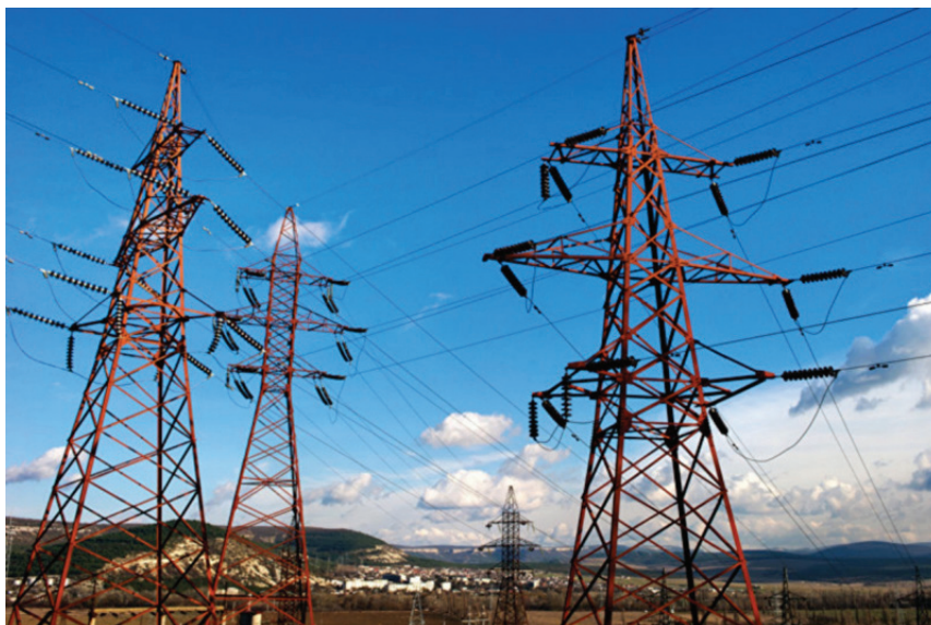
Рис. 3. Провод AAAC-Z на решетчатых опорах ВЛ 220 кВ Крымского энергомота, п-ов Тамань, 2016
