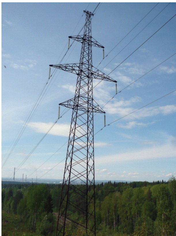
Рис. 1. Двухцепная опора №12 (207) на трассе ВЛ 220 кВ Кондопога – Медвежьегорск и ВЛ 220 кВ Кондопога-Кондопога (Л-214), марка – П220-2Т
