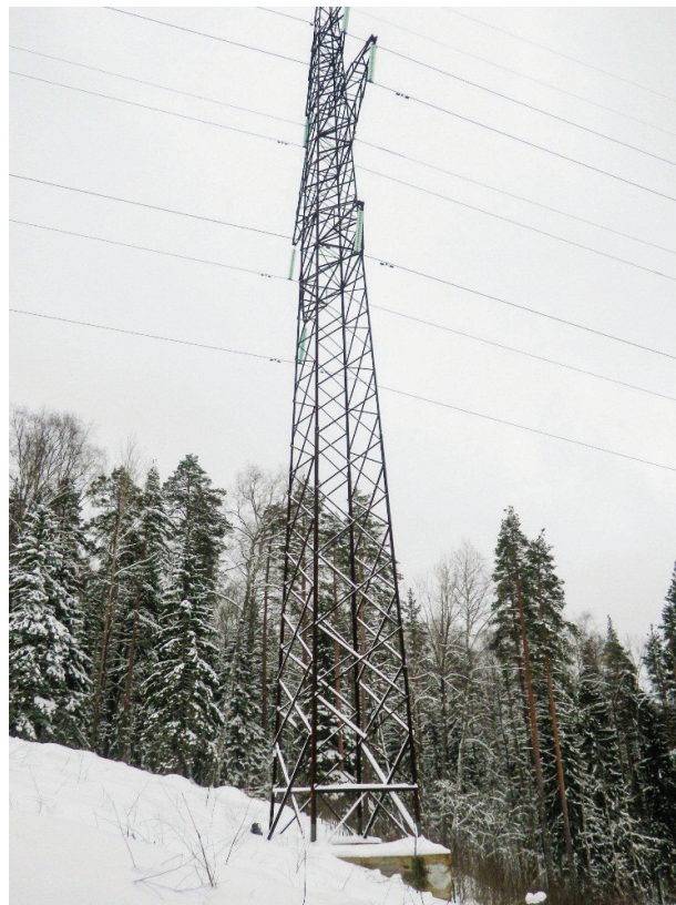
Рис. 2. Отклонение опоры №12 от вертикали
