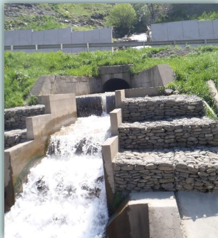
Водопропускные сооружения под дорожным полотном
