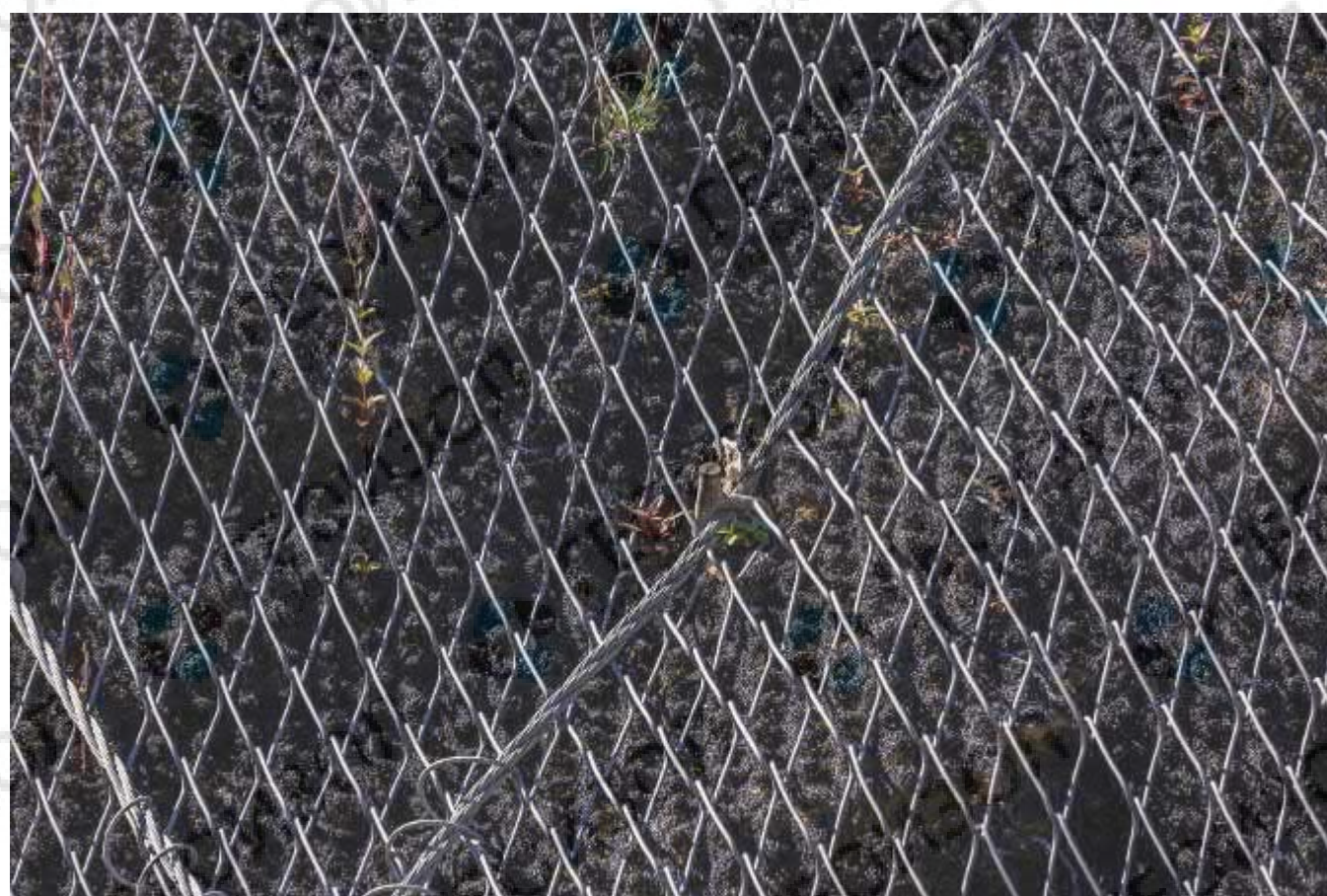
Узел крепления противозрозионной защиты забивным анкером. Сочи
