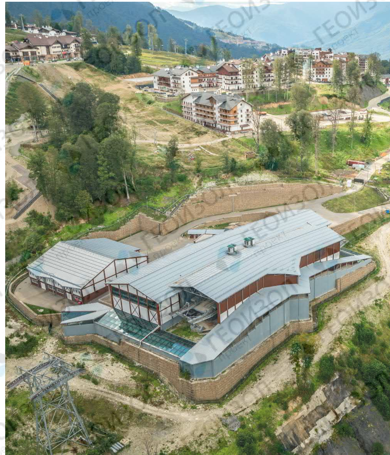
Подпорная стена из габионов для защиты от оползней станции канатных дорог, возведенная при планировке стройплощадки. Горнолыжный курорт «Роза-Хутор», Сочи.
